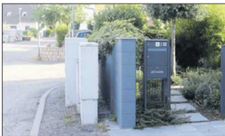
Die Mauer hinter den Kästen muss weiter nach hinten versetzt werden: Sie steht zu weit draußen. FOTO: BENNDORF
